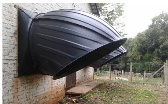
Figura 2: Exaustores na parte externa do módulo. Fonte: Autor, 2015.
