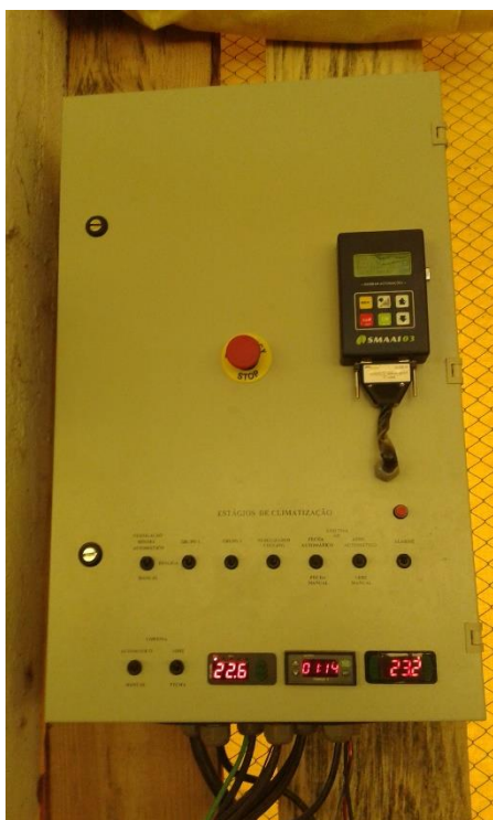
Figura 3: Painel de controle do climatizador. Fonte: Autor, 2015.
