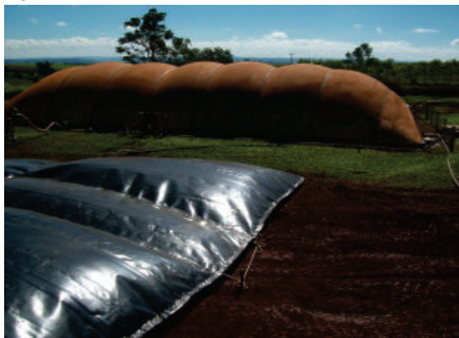
Figura 5: Biodigestor e balão de armazenamento
